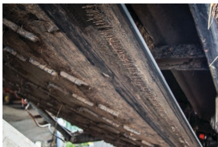
Poškodený pôvodný gumový dopravníkový pás
